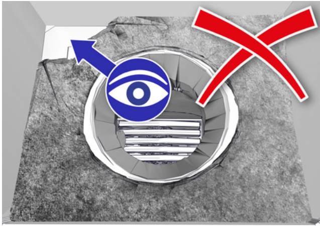
Fig. 5-40: Joint de chambre de combustion défectueux
